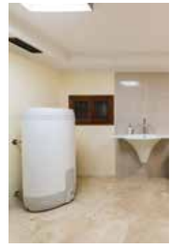
Bei der Miete einer neuen Heizung übernimmt der Anbieter die Anschaffung wie Installation und organisiert die regelmäßige Wartung durch einen qualifizierten Handwerksbetrieb. Foto: djd/www.ewe.de/ Evgeny Korshenkov - stock.adobe.com
